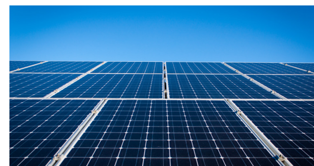
太阳能组件 Solar panel
